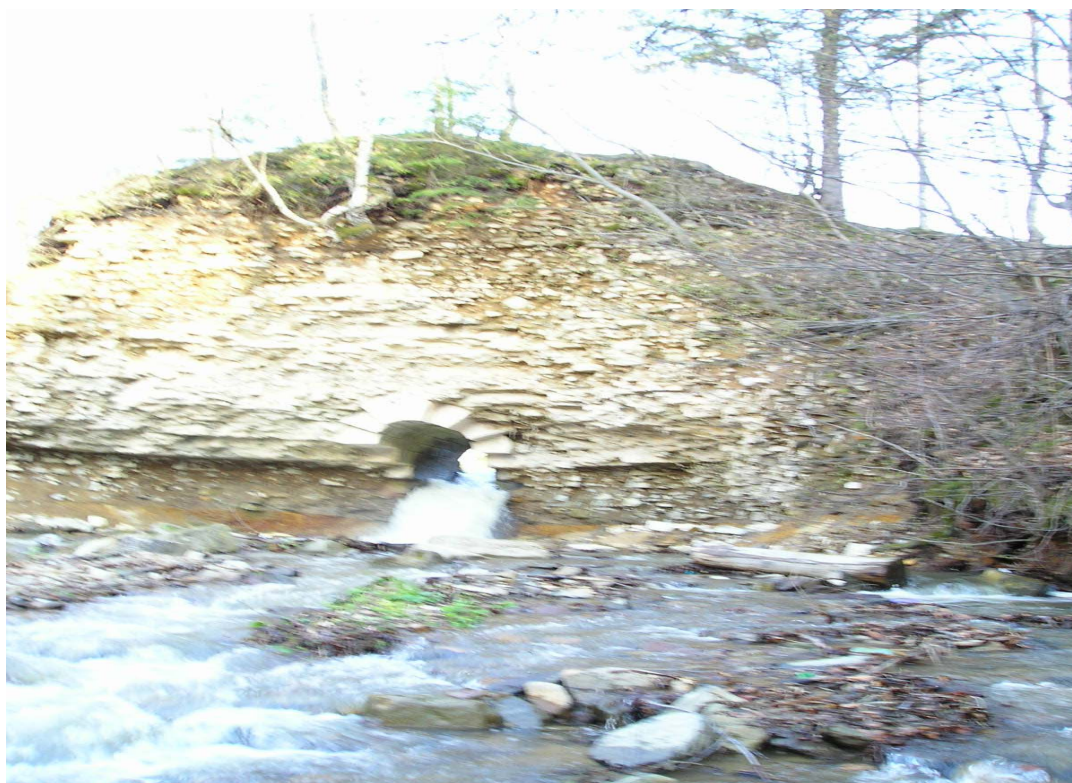
Obr. 2 Pohľad na porušenú kamennú murovanú priehradu v Zlatej Bani s dnovým výpustom zo vzdušnej strany (máj 2005)
