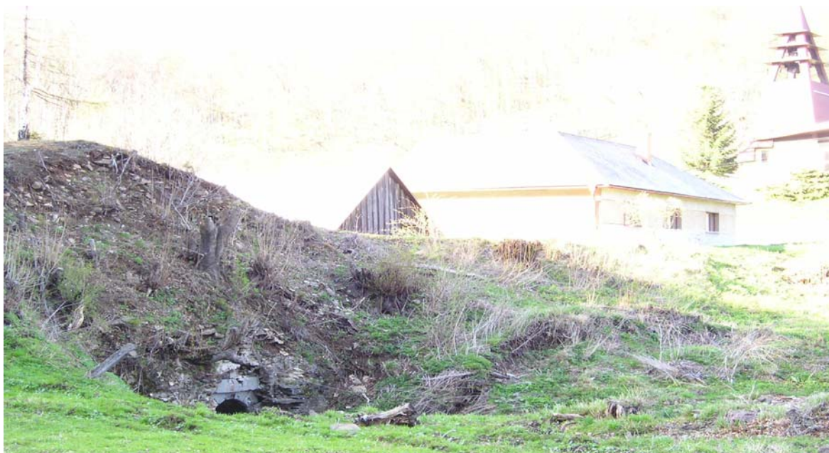
Obr. 3 Pohľad na návodný svah porušenej kamennej murovanej priehrady s čelom dnového výpustu v Zlatej Bani a najbližšie okolie (máj 2005)
